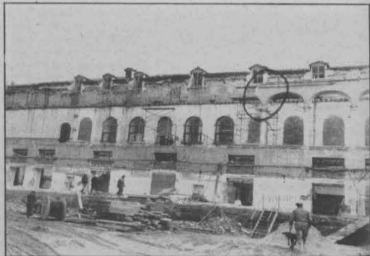
Mutilación del palacio de los Benavente con fines especulativos. En ella participan gerifaltes de la UCD y otros oligarcas de Valladolid
