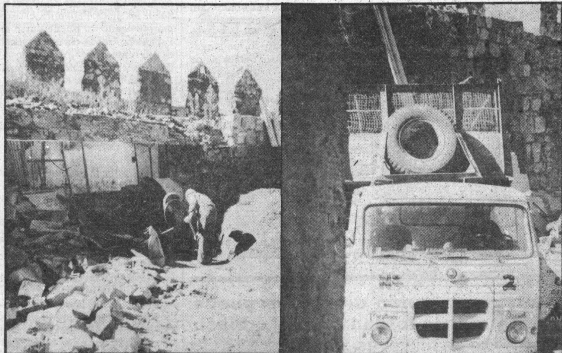
Losas, vigas, piedras enormes: un constante atentado que ya dura año y medio contra la histórica muralla abulense
