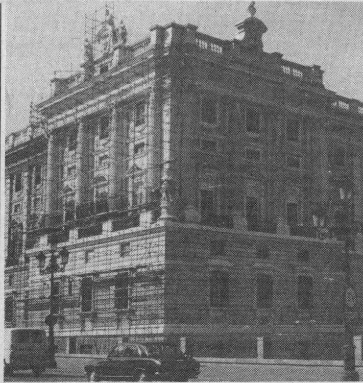
Vista del palacio de Oriente, en Madrid, verdadero museo, durante las obras de restauración de la fachada
