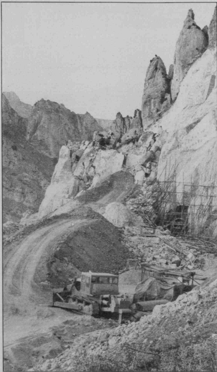
El túnel se vino abajo y hubo que coserlo de nuevo.
