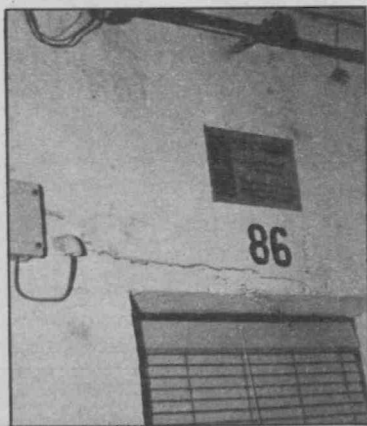
Ciento veinte viviendas: mil y pico grietas.
