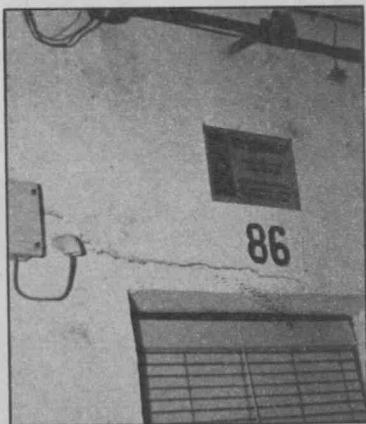
Ciento veinte viviendas: mil y pico grietas.
