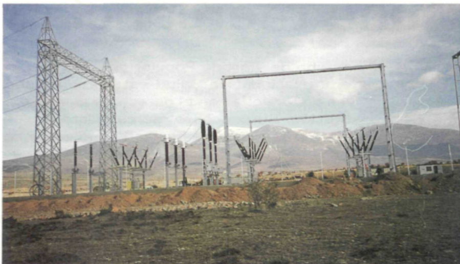
Subestación de transformación de energía eólica en el valle de Araviana. Al fondo, el Moncayo.
